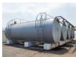
· IBC y tanques de fluido
